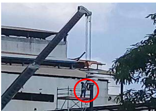
Figura 1. Acto inseguro, trabajador sujeta carga suspendida colocándose en la última baranda del andamio. Incumplimiento a normas y procedimientos.
