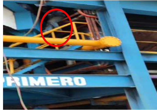
Figura 4. Trabajador se expone a caída y posible muerte colocándose sobre barandilla de escalera para realizar trabajo en caliente sin equipo de protección personal específico.
