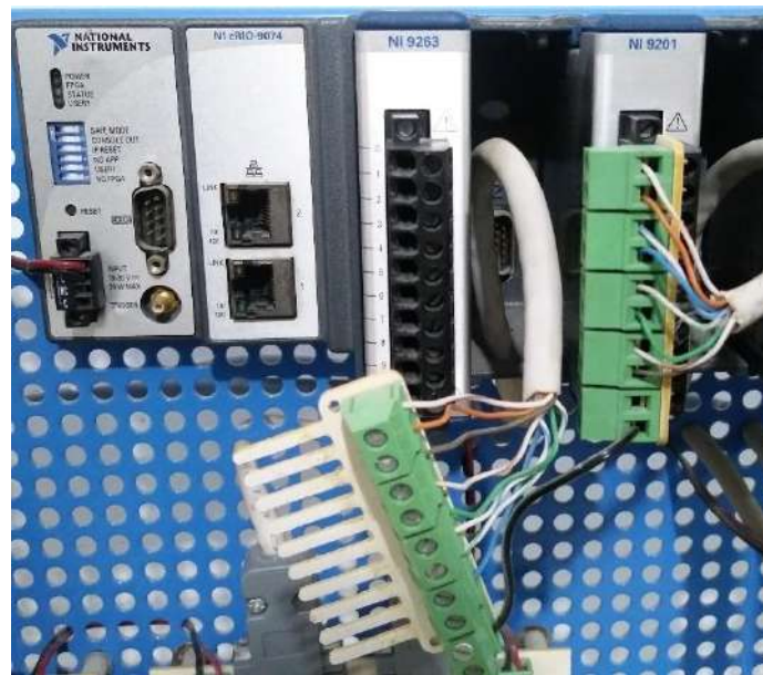
Figura 5.- Tarjetas electrónicas tipo peine para conexión de señales a módulos NI 9201 y NI 9263.
