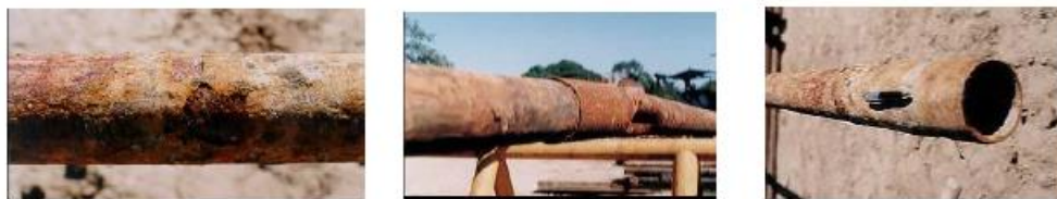
Figura 7. Corrosión combinada H 2 S y CO 2
