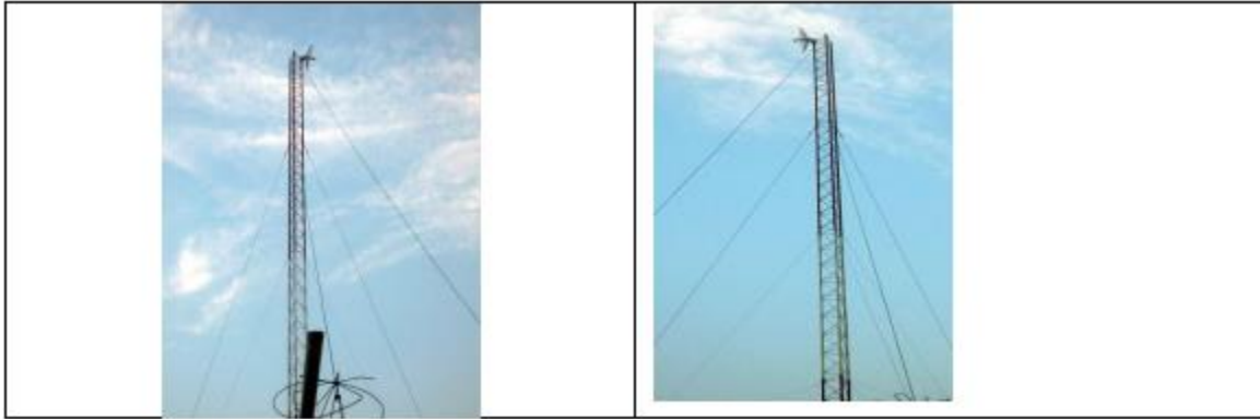
Figura 4. Torre de Comunicación con antenas ubiquiti
