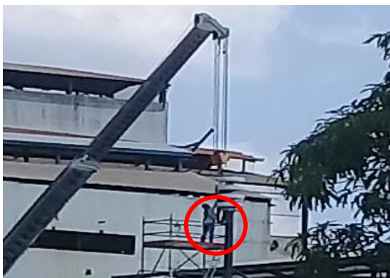
Figura 1. Acto inseguro, trabajador sujeta carga suspendida colocándose en la última baranda del andamio. Incumplimiento a normas y procedimientos.
