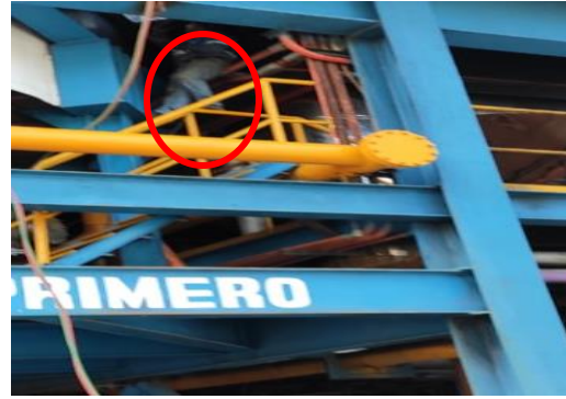
Figura 4. Trabajador se expone a caída y posible muerte colocándose sobre barandal de escalera para realizar trabajo en caliente sin equipo de protección personal específico.
