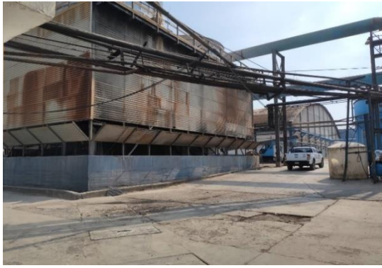
Figura 3. Condiciones Inseguras, caída de estructura que soporta tuberías y líneas eléctricas.
